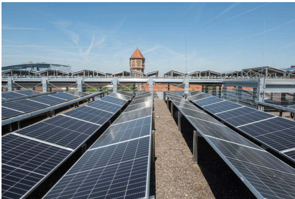
PV Anlage auf dem Dach des „Parkhauses der Zukunft“, Fotocredit: winklerbild.de
